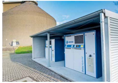
Zwei Delta Hybrid sind im Außenbereich der Kläranlagen unter einem schützenden Dach platziert.
