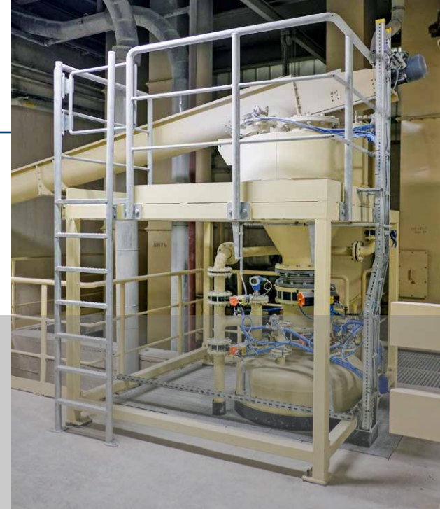
ISS Schüttguttechnik hat die neue Stuckgipsversorgung gemeinsam mit Knauf Engineering geplant und realisiert.
