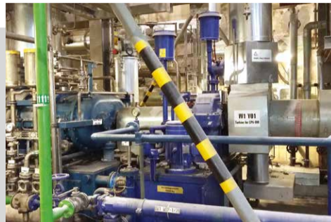
VKO 725S zur Verdichtung von Kalkofengas mit Turbinenantrieb – Baujahr 1976
