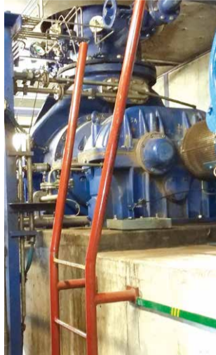
VRa 736L zur Verdichtung von Styren Monomer Offgas
