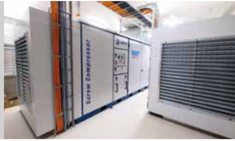
Blick in die Instrumentenluftversorgung
