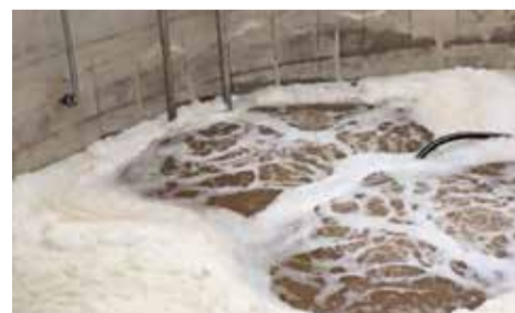
Bubble-Test der Belüfterplatten in dem sich füllenden Becken
