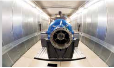
Die AERZEN Anlage stellt die Druckluft für die Prüfstände (hier Luftturbine) im Forschungsneubau „Dynamik der Energiewandlung“ der Universität Hannover bereit, auf denen die komplexen Strömungsphänomene in Hochleistungsturbomaschinen erforscht werden.
