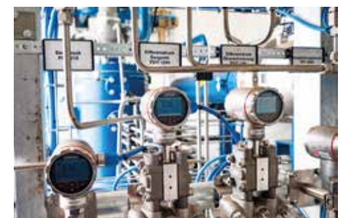
AERZEN lieferte für EWE eine einbaufertige Komplettlösung inklusive Verrohrung und Anbindung an die Steuerungsebene.
