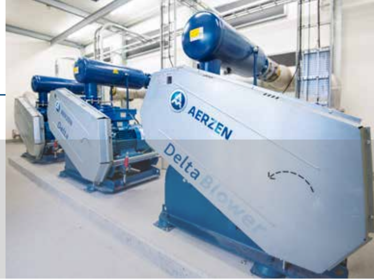
Ein Verbund aus AERZEN Drehkolbengebläsen vom Typ Delta Blower übernimmt an einem Arla-Produktionsstandort die Gasversorgung. Die Gebläsestufen sind mit Blick auf die Standardisierung durchgängig gleich.
